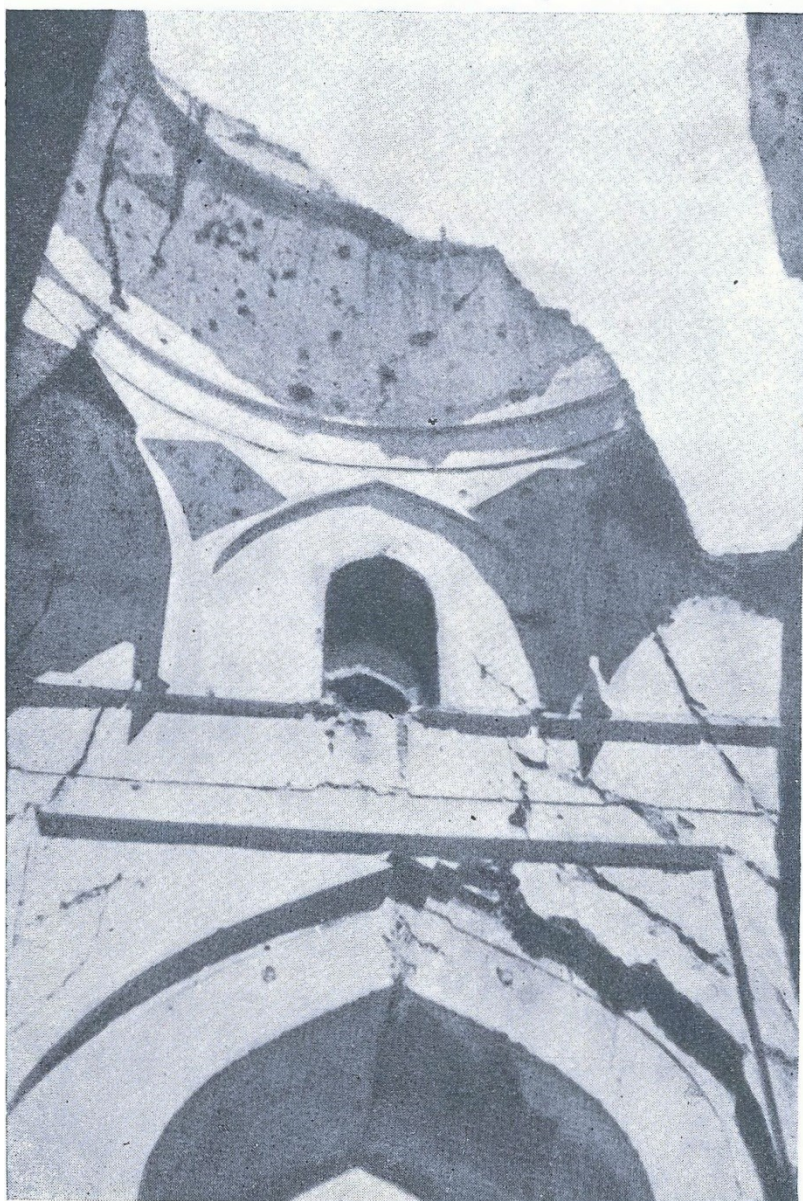
Рис. 34. Деформация парусов и свода.
