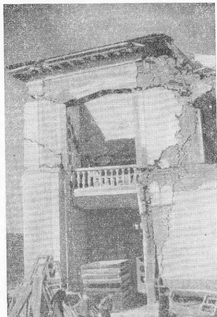
Рис. 63. Повреждение угловых лоджий и срез боковых пилонов
