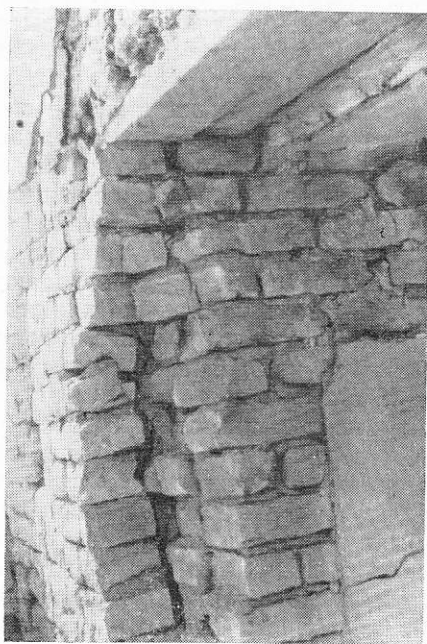
Рис. 44. Расслоение кирпичной кладки простенка
