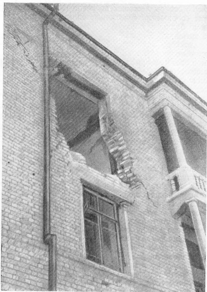
Рис. 51. Обрушение железобетонного балкона
