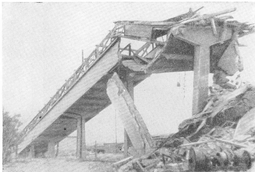
Рис. 175. Разрушение железобетонных стоек и перекрытия взгона
