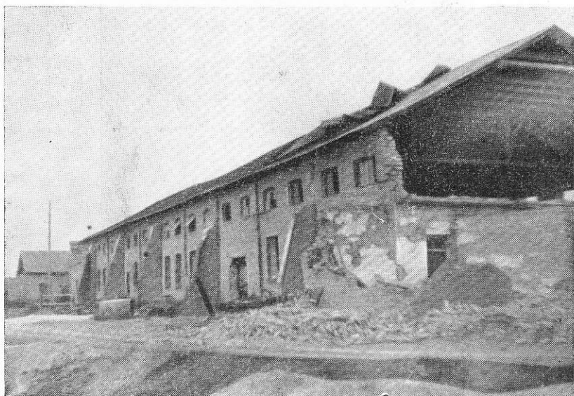
Рис. 163. Литейный цех после землетрясения
