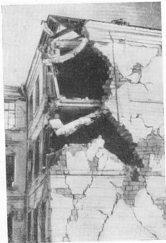
Рис. 90. Разрушение угла здания
