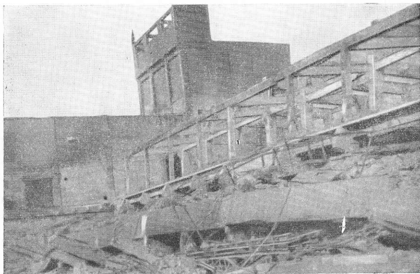
Рис. 133. Повреждение железобетонных рам
