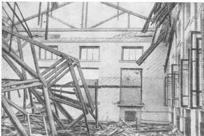
Рис. 70. Разрушенные деревянные дощатые фермы над актовым залом
