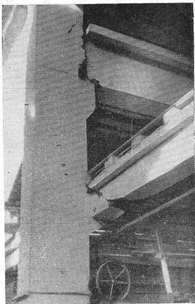
Рис. 156. Стык сборных элементов здания тепловозного депо разошелся
