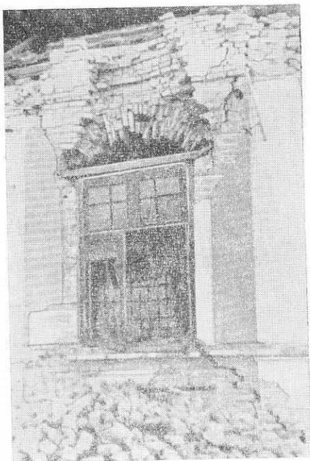
Рис. 236. Разрушение клинчатых перемычек
