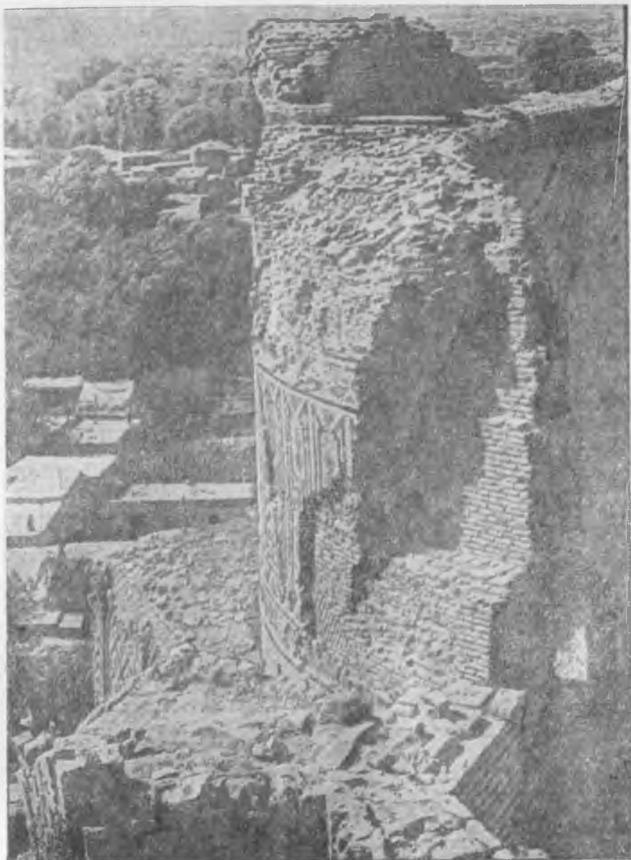
Рис. 11. Сопряжение барабана и купола Большой мечети. Характер состояния кладки, находящейся в зоне активного выветривания (фото Л. Ю. Маньковской).
