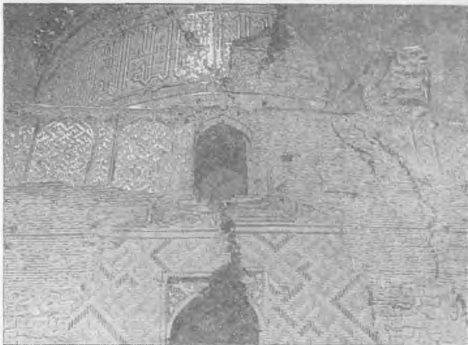
Рис. 10. Фрагмент фасада южной стены Большой мечети — разрыв и сдвиг пояска, свидетельствующий о повороте юго-восточного пилона; трещины от распора восьмерика и разрушение облицовки в зонах «камнепадов».
