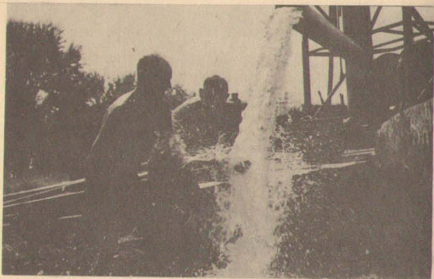
Пошла вода из скважины.
