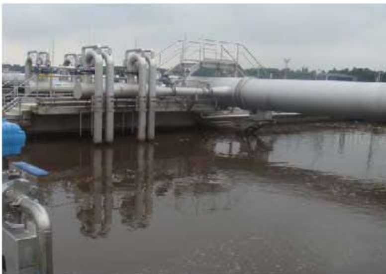
Фото 6.1. Очистные сооружения сточных вод г. Варшавы (Польша)
