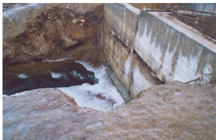
Рис. 1. Утечка воды через аварийное гидротехническое сооружение
