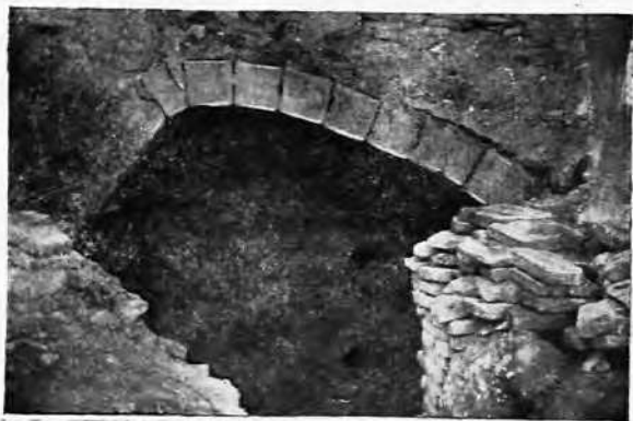
Рис. 27. Деформированный свод подземного помещения.
