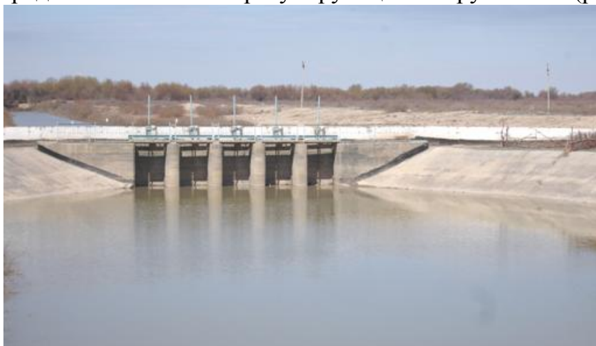
Рисунок 1 – Регулирующее сооружение на оросительном канале.
