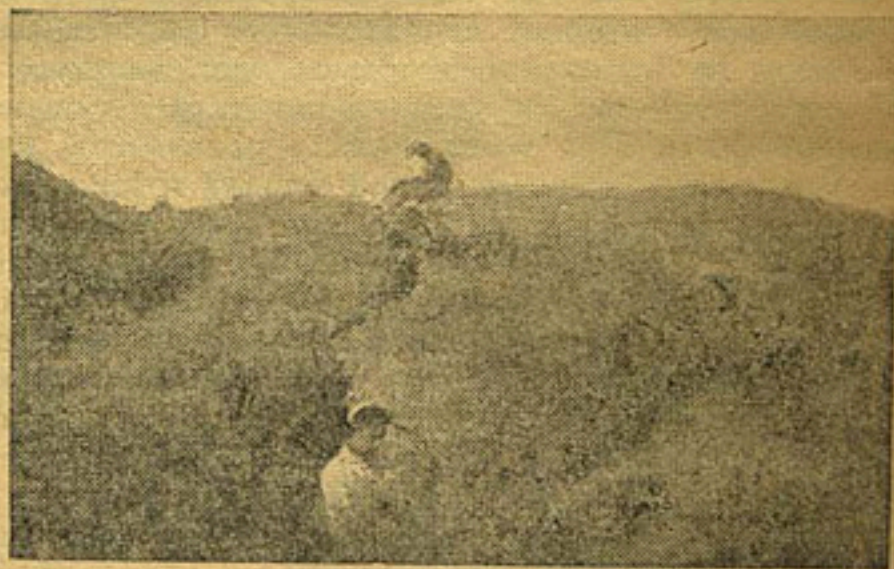
Рис. 2. Трещина оседания на канале Старый Джун
