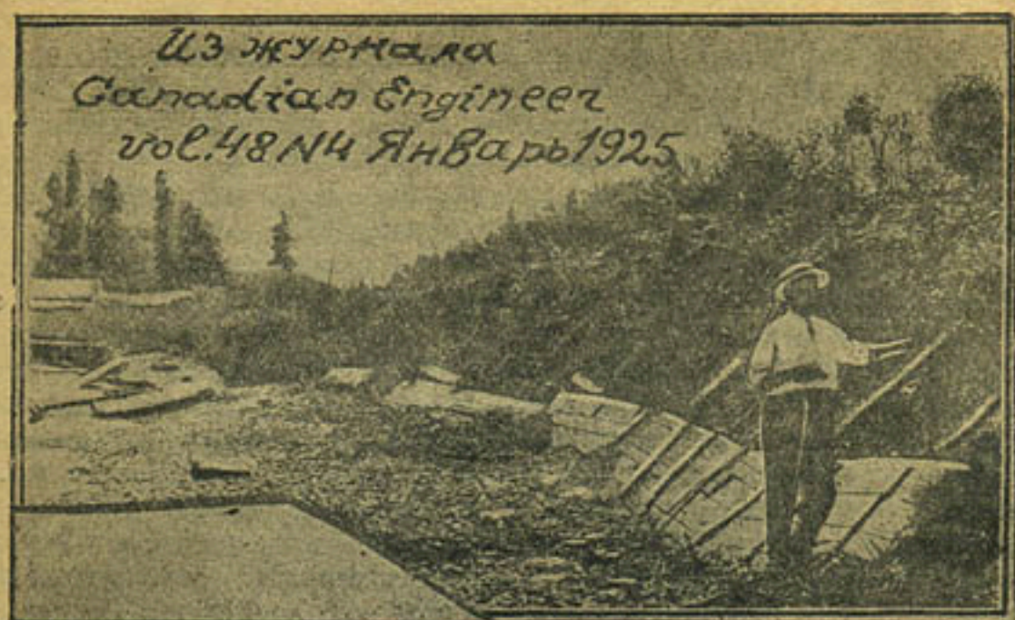
Рис. 2 Временная защита подошвы берега
