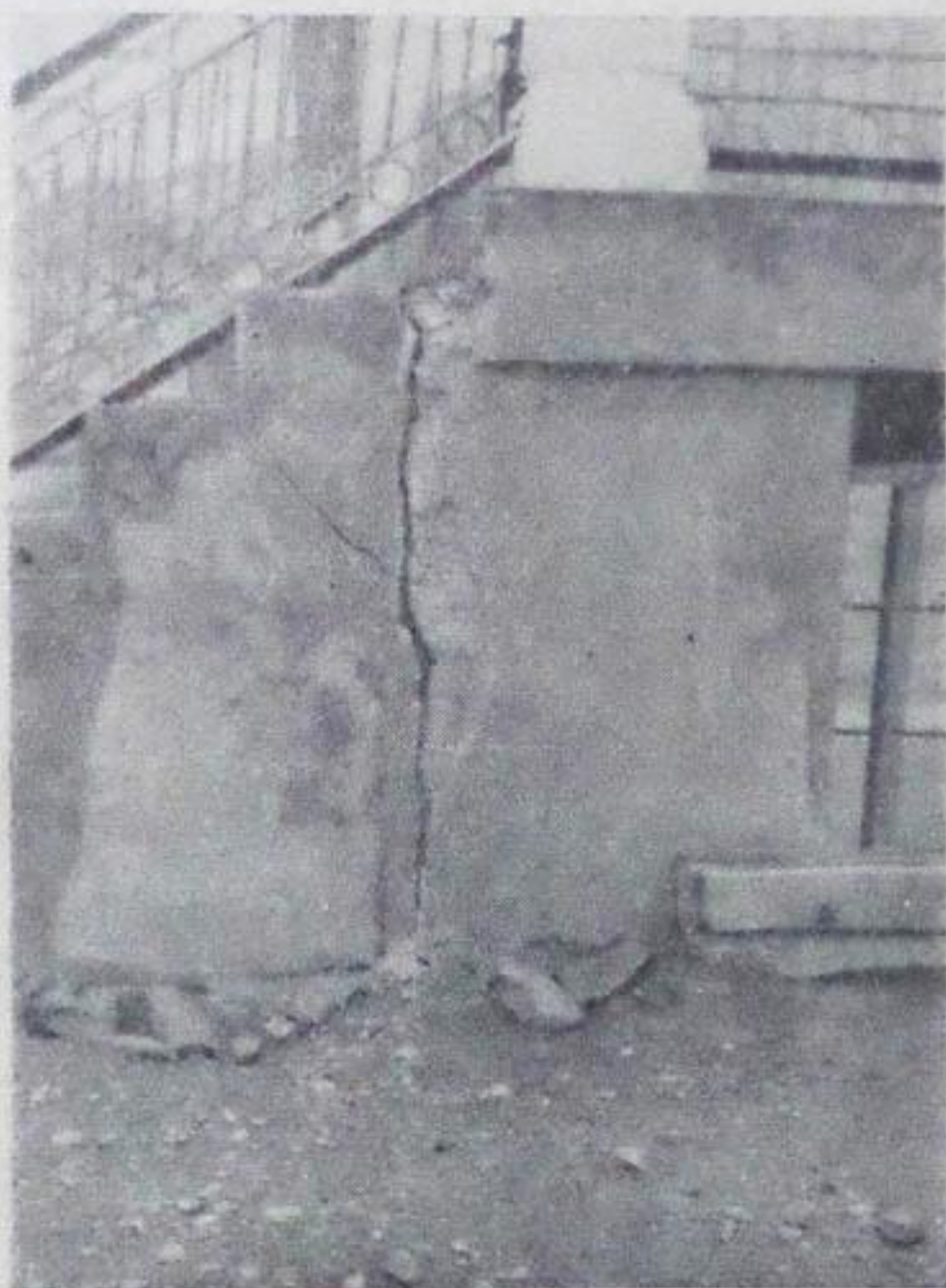
Рис. 5. Трещина от динамического воздействия потока (такая же трещина и с правой стороны устоя).
