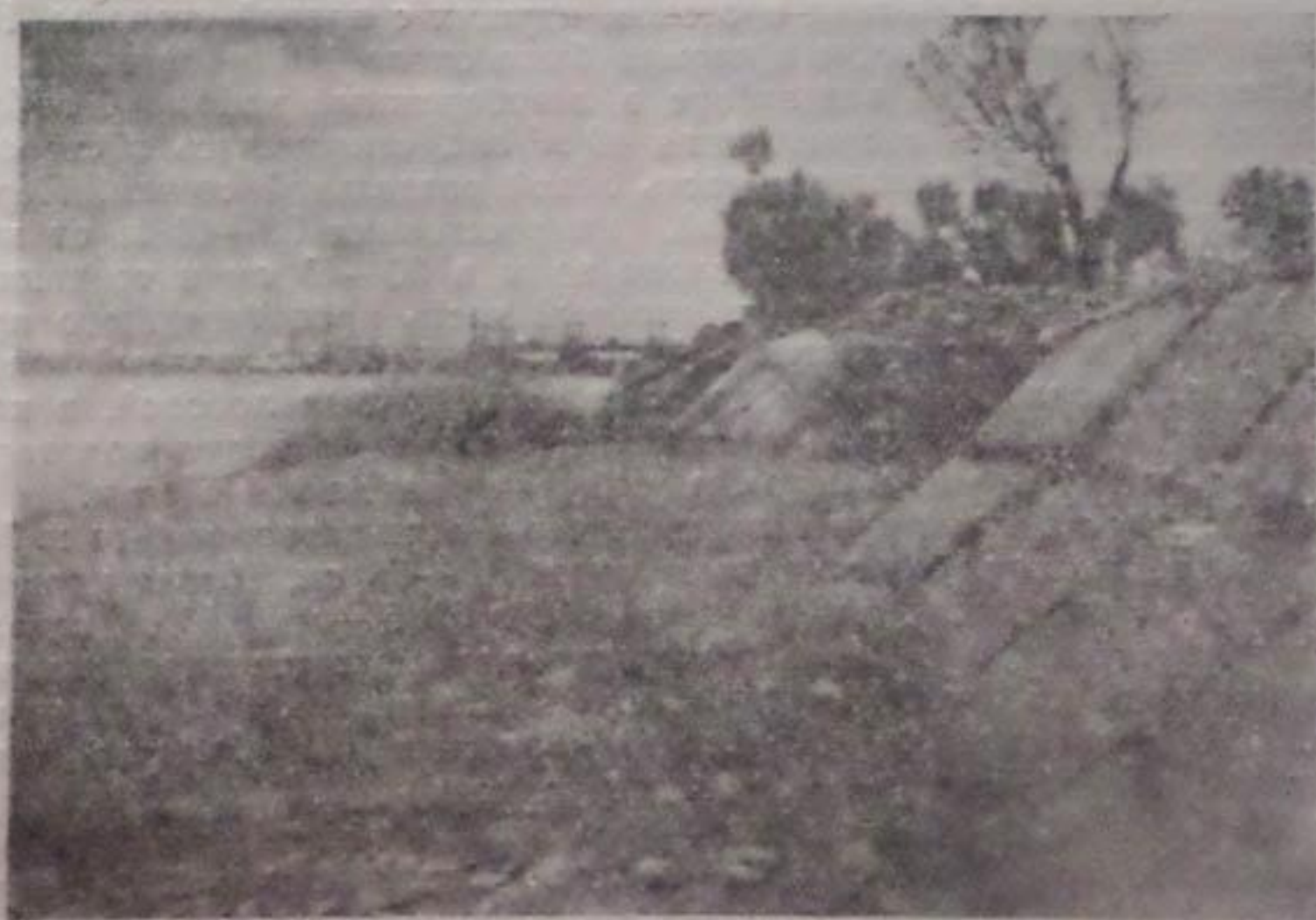
Рис. 23. Разрушение правой струенаправляющей дамбы выше отверстий кольматажного озера.
