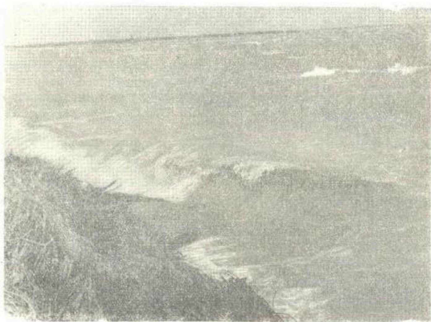
Рис. 7. Тедженское водохранилище; разрушение фашинного крепления ветровой волной.
