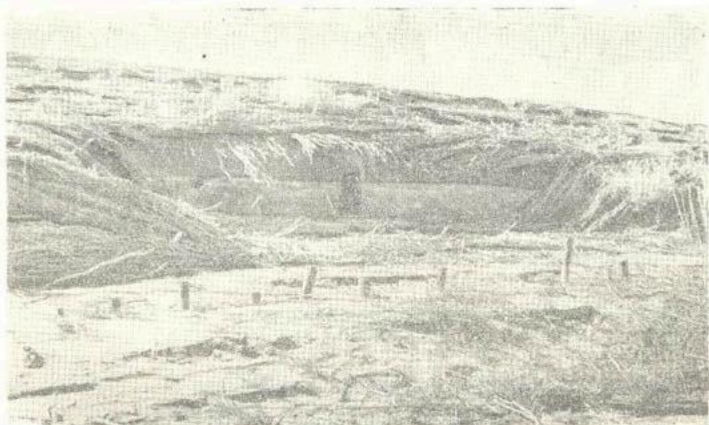
Рис. 8. Тедженское водохранилище; разрушенное фашинное крепление левой дамбы.
