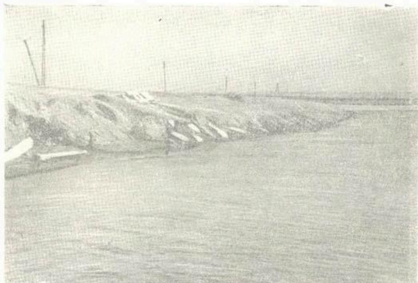
Рис. 5. Кайраккумское водохранилище; вид разрушенного крепления поселковой дамбы.
