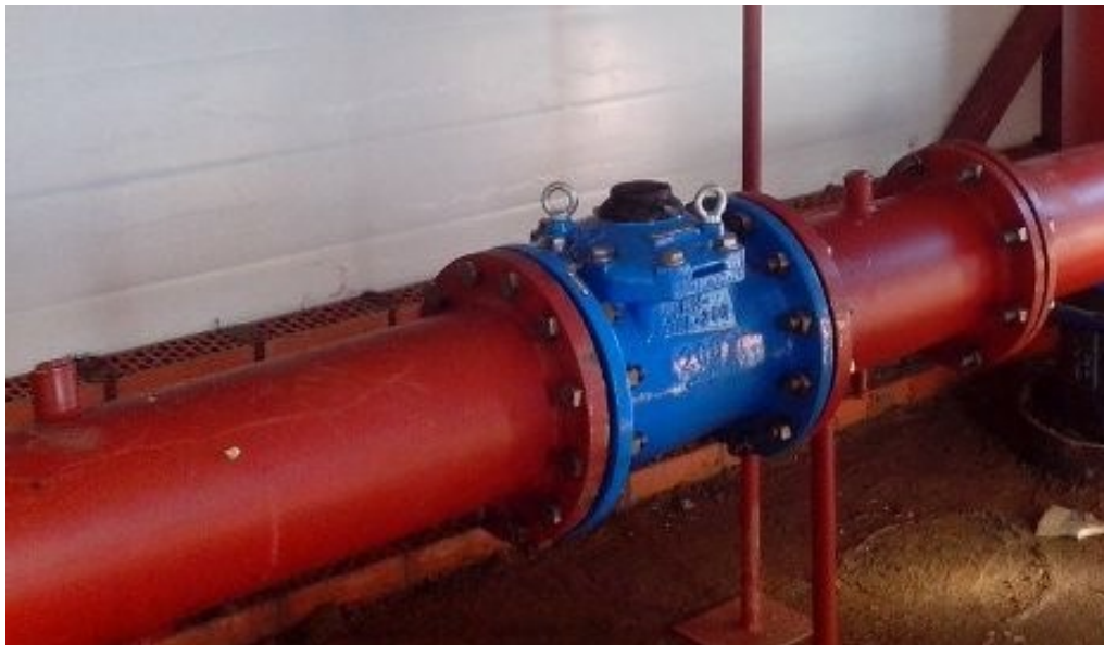
Рисунок 4 – Расходомер на всасывающем трубопроводе (фото Д. С. Цыпленкова)
