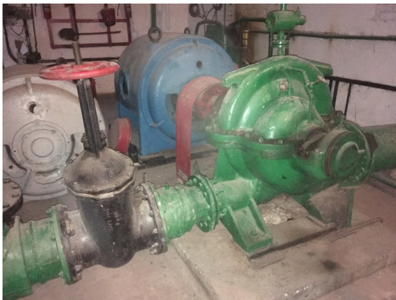
Рисунок 1 – Насосно-силовое оборудование насосной станции «Рассвет-8» (фото Д. С. Цыпленкова) Figure 1 – Pumping and power equipment of the Rassvet-8 pumping station (photo by D. S. Tsyplenkov)
