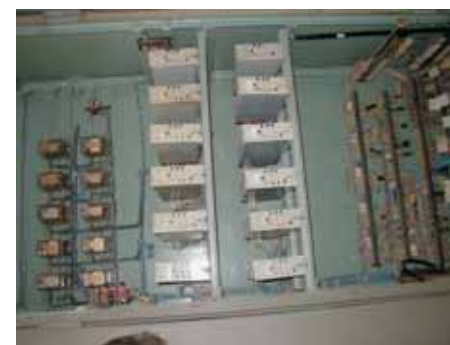
Рис. 3. Шкаф с преобразователями
