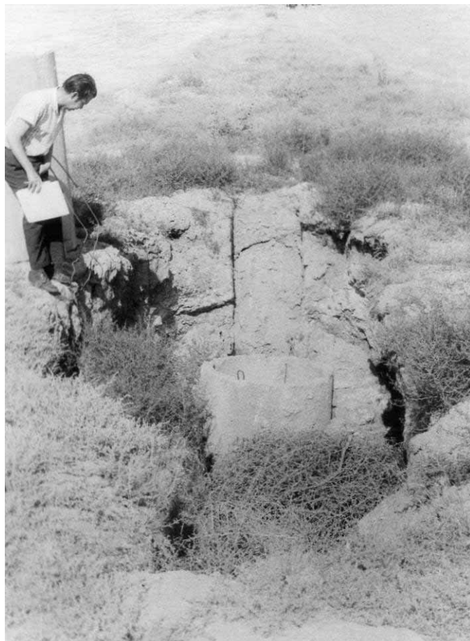
Рис. 2.3. Ирригационная эрозия вокруг дренажных колодцев
