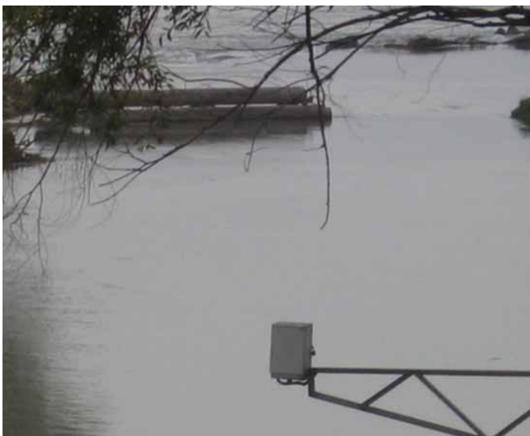
Рис. 2. Установка датчика уровня воды
