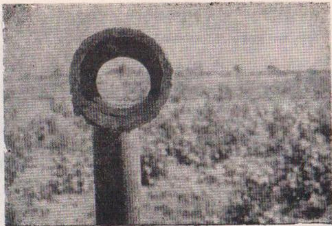
Рис. 6. Заилнение трубок горизонтального дренажа после 5 лет эксплуатации.
